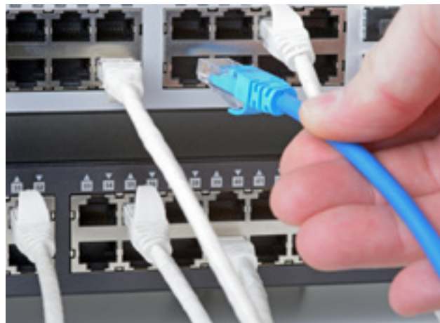
Placówka medyczna odpowiada za bezpieczeństwo okablowania pomieszczeń placówki medycznej, a firma zapewniająca kolokację – w zakresie okablowania znajdującego się w serwerowni
